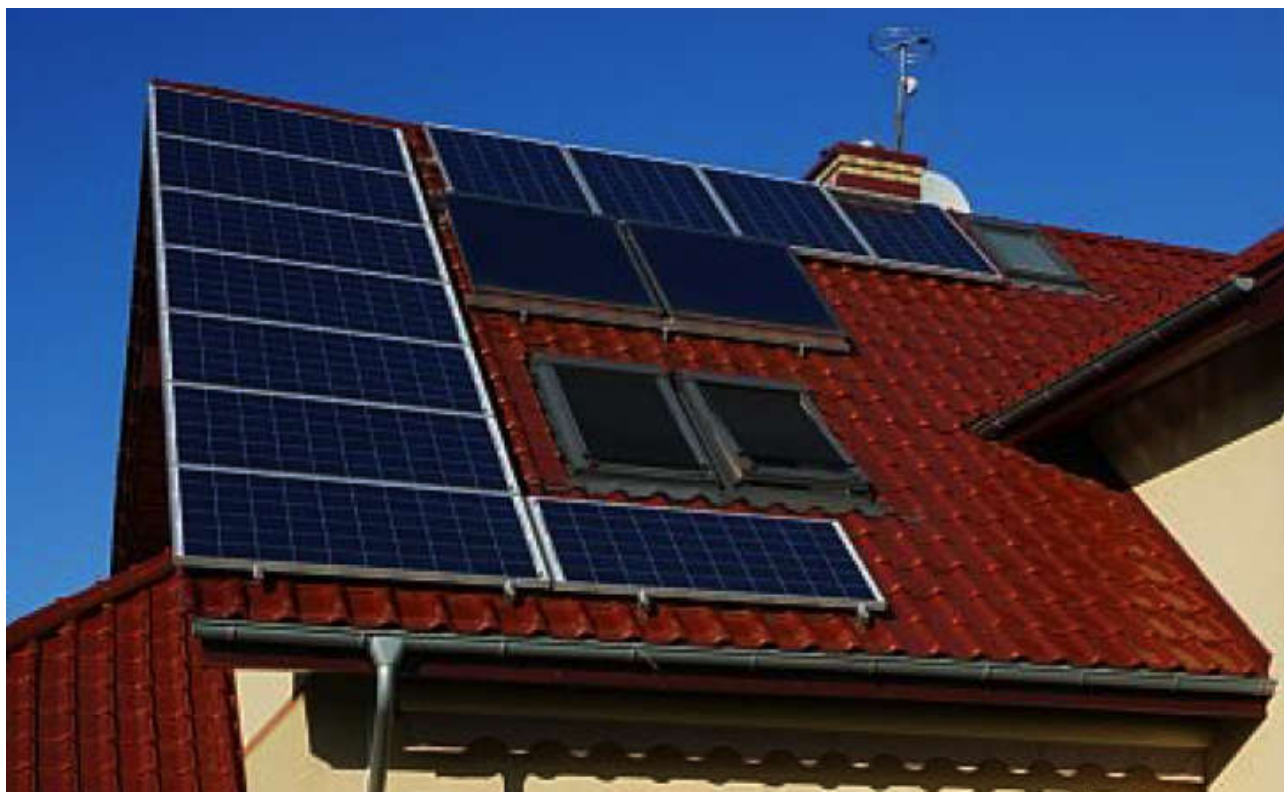
Dzięki programowi „Prosument na Warmii i Mazurach” w regionie powstało 112 instalacji fotowoltaicznych Fot. Archiwum
